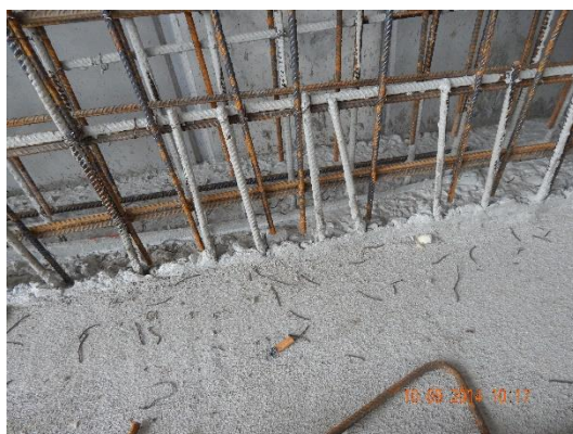
Stellenweise Verunreinigungen am Fugenblech
