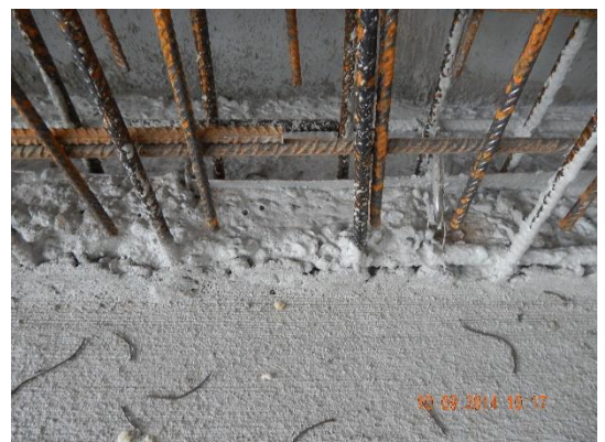
Durch fehlerhaften Betoneinbau stellenweise verunreinigtes Fugenblech
